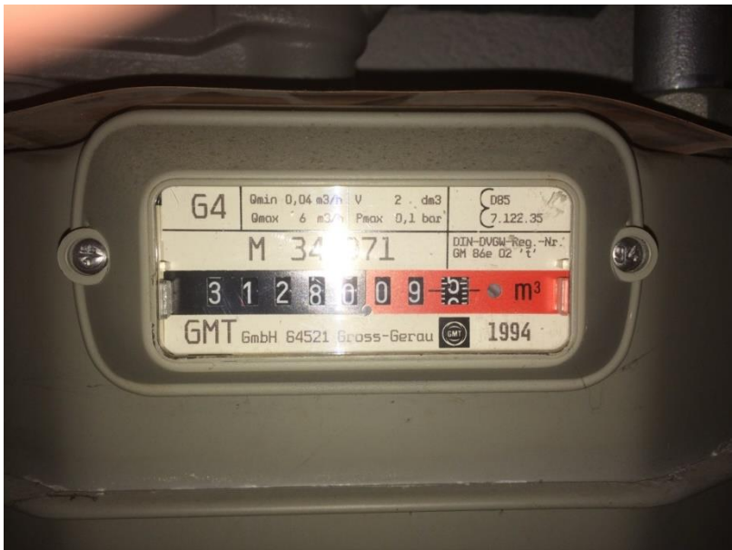
Abbildung 10: Erdgasmessuhr zur Ermittlung der zugeführten Energie
